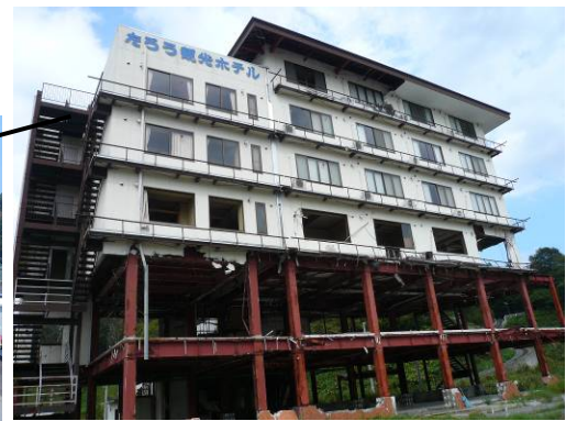
ぽつり残されたホテル “物言わぬ語り部”として 残したいとの声も！
