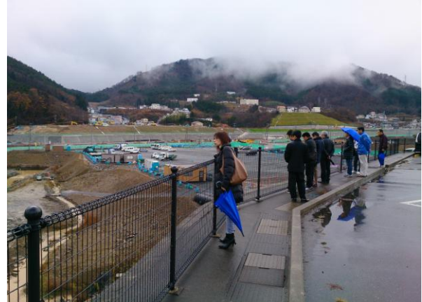
津波の被害が大きかった女川町の沿岸では、現在、復興に向けて大規模な工事が実施されています。
